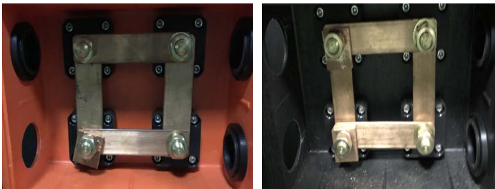
储能箱正负极接口箱内部
